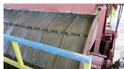
3. Spălarea grătarului mecanic rotativ
