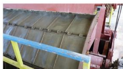
3. Spălarea grătarului mecanic rotativ
